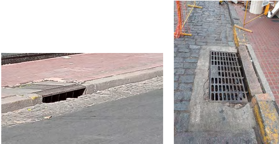
Figura 5. Izquierda Sumidero Tipo Ventana. Derecha Sumidero Tipo Mixto. Calle Bolívar 1400
