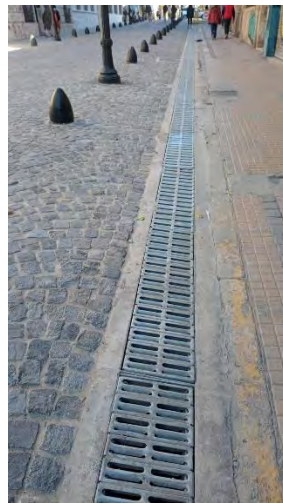
Figura 6. Sistema de captación Tipo Acequia con rejilla (canal lateral). Calle Bolívar 1000
